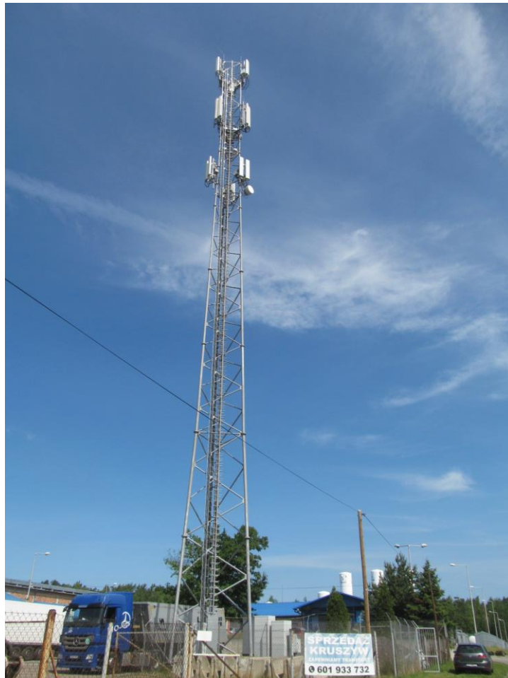
Zał. nr 1: Widok ogólny instalacji radiokomunikacyjnej.
